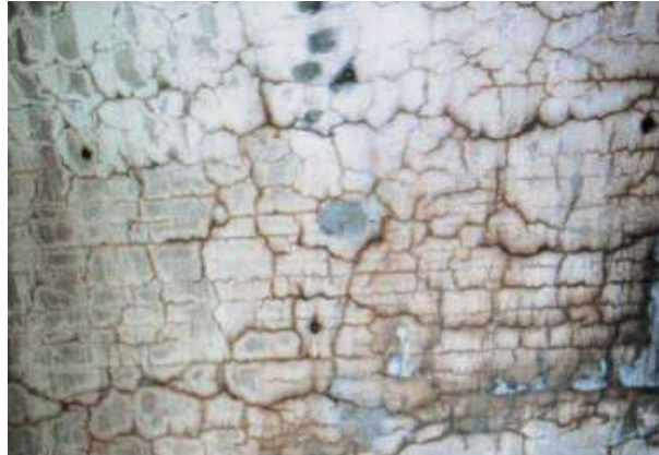
Abb. 10.7.14 Starke Rissbildung infolge Quellens des Betons, verursacht durch eine Alkali-Kieselsäure-Reaktion
