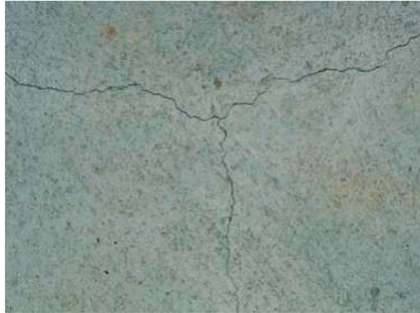
Abb. 10.3.10 Risse auf Grund von Trocknungsschwinden
