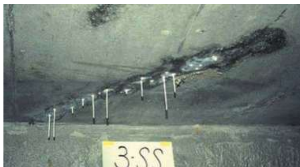
Abb. 10.3.1 Durchgehende Risse mit Wassereindringung als Folge behinderten Schwindens in einer Parkhausdecke
