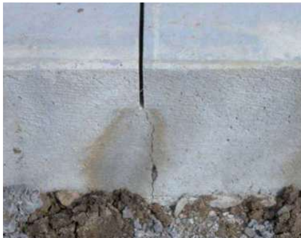
Abb. 8.4.5 Planmäßig eingeschnittene und gerissene Fuge
