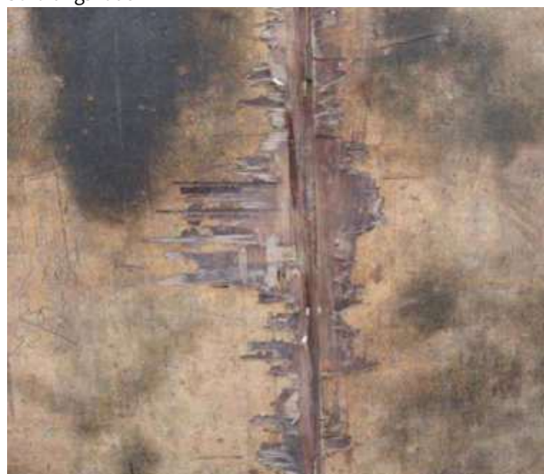
Abb. 8.3.17 (links) Beschädigte Schalungshaut
