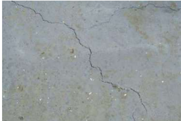
Abb. 8.5.3 Risse infolge Fröhschwinden (Austrocknung)
