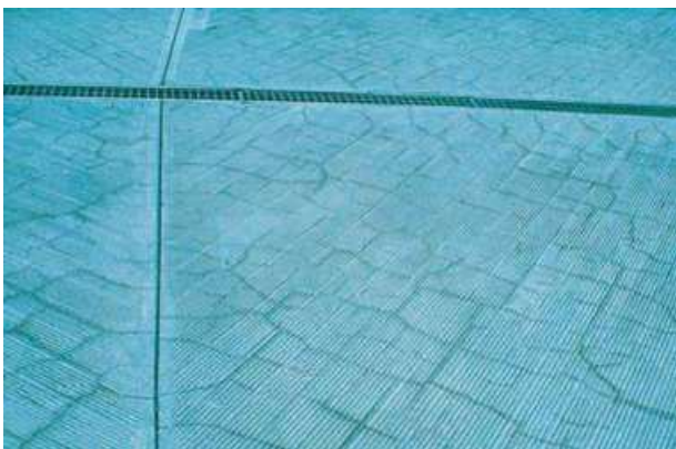
Abb. 10.3.7 Rissnetz aufgrund plastischen Schwindens auf einer Parkhausdecke
