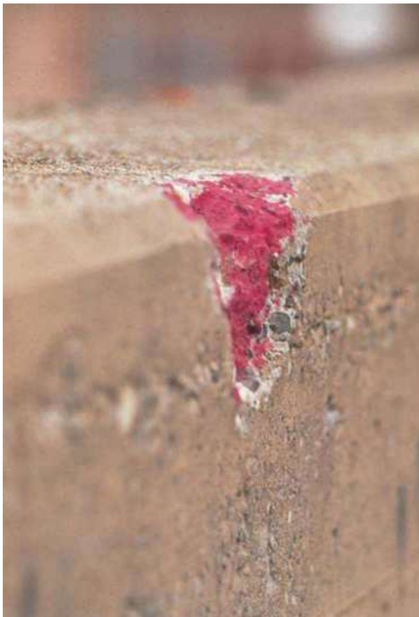
Abb. 10.8.1 Karbonatisierungsf front, die mit dem Phenolphthalein-Test auf einem Betoneinschnitt sichtbar gemacht worden ist. Wo das Phenolphthalein den Beton violett einfärbt, ist der Beton noch nicht karbonatisiert.
