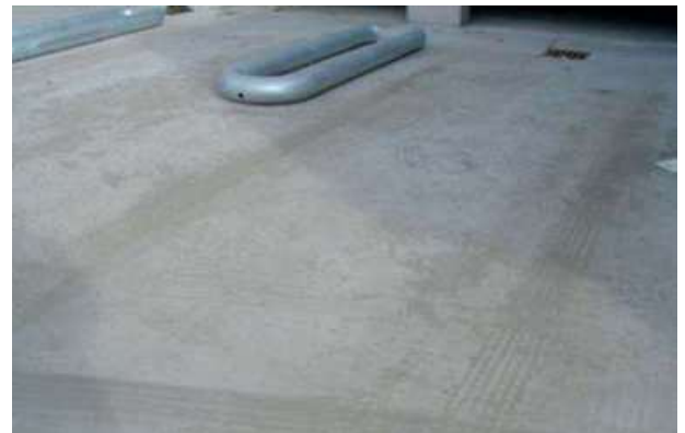
Abb. 10.4.1 Frost-Tausalz-Schaden an Beladerampen bei einem Speditionsauslieferungslager
