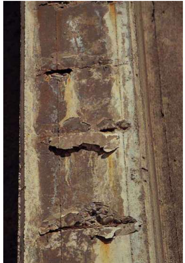
Abb. 10.8.2 Bauteil, bei dem die ungenügende Überdeckung der Bewehrung als Folge der Karbonatisierung und der Korrosion abgesprengt worden ist
