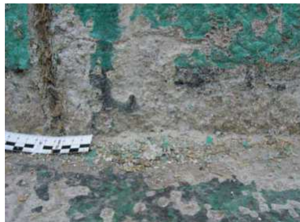
Abb. 10.5.4 (links) Lösender chemischer Angriff auf Betonoberfläche
