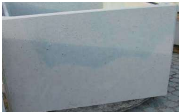
Abb. 10.2.19 Schachtbauteil mit Blauverfärbung auf der geschalteten Oberfläche
