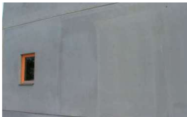
Abb. 10.2.18 Verfärbung durch das Gegeneinanderstellen unterschiedlicher Bauteile
