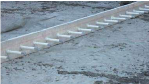
Abb. 8.4.20 und Abb. 8.4.21 Pressfuge/Arbeitsfuge
