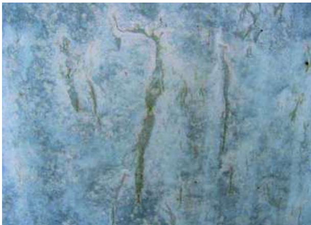
Abb. 8.3.11 Trennmittel zu dick aufgetragen- Fleckenbildung und Porenanhäufung
