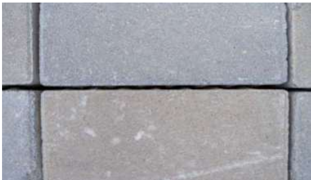
Abb. 10.2.15 Braunverfärbung durch Eisenionen des Zements
