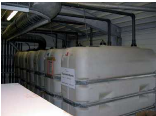
Abb. 1.5.7 Vorschriftsmäßiges Tanklager für Zusatzmittel in einem Transportbetonwerk
