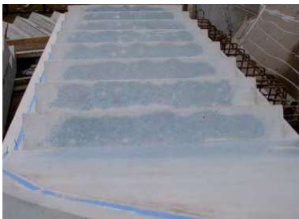
Abb. 10.2.20 Treppe mit Blauverfärbung auf der geschalteten Oberfläche
