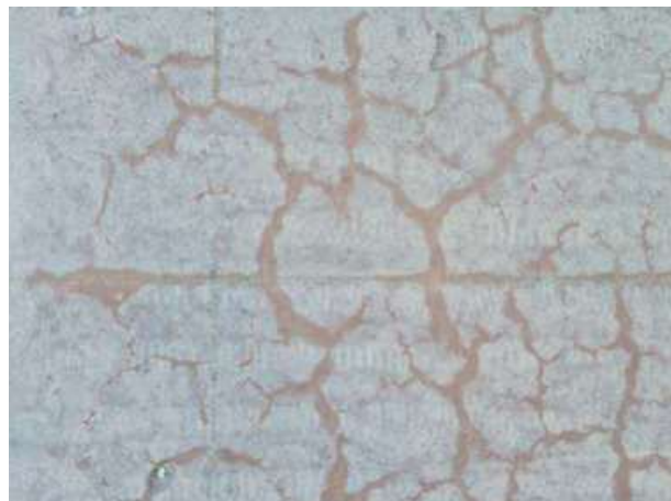
Abb. 10.7.11 (links) Rissbildung als Folge einer Alkali-Kieselsäure-Reaktion
