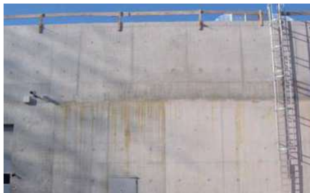
Abb. 10.2.11 (links) Braunverfärbungen durch Rosten der Bewehrung
