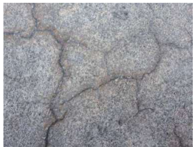
Abb. 10.7.1 Schadensbild einer Alkali-Kieselsäure-Reaktion
