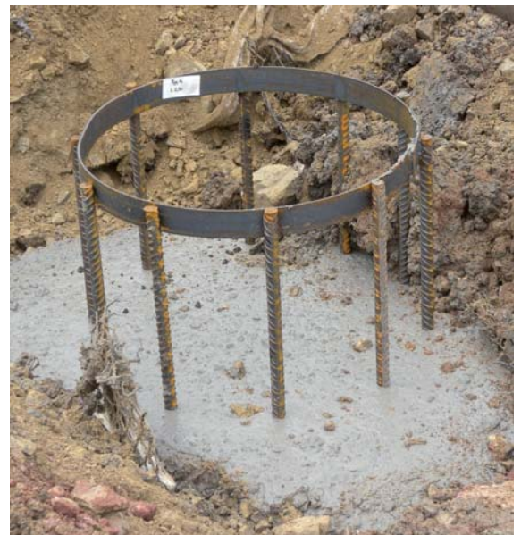
Bohrpfahl in sulfathaltigem Boden
