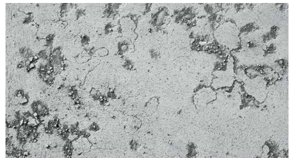
Abb. 9.3 Risse infolge Austrocknung
