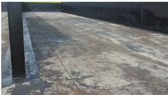
Abb. 2.1 Fahrsiloboden mit Schäden
