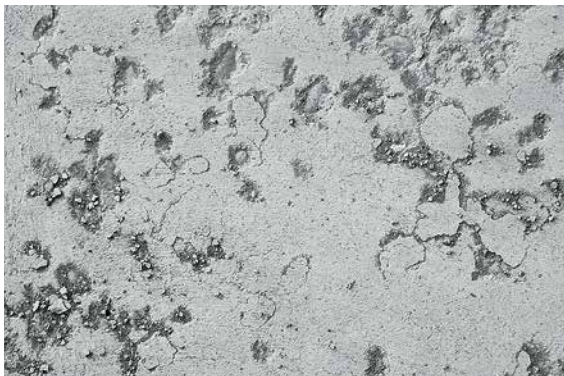
Abb. 8.1 Frostschäden an der Betonoberfläche
