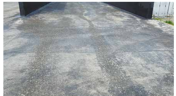
Abb. 2.2 Starker Angriff auf die Betonoberfläche
