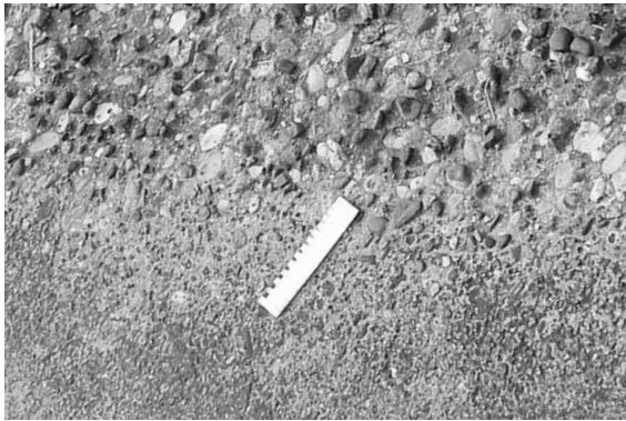
Abb. 11.1 Starke Abwitterung der Betonoberfläche
