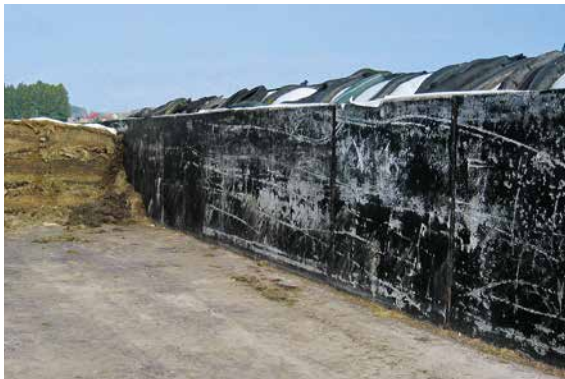
Abb. 12.1 Mechanische Beschädigung an der Wand
