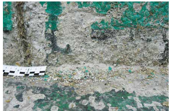
Abb. 12.6 Vollkommen zerstörte Betonoberfläche
