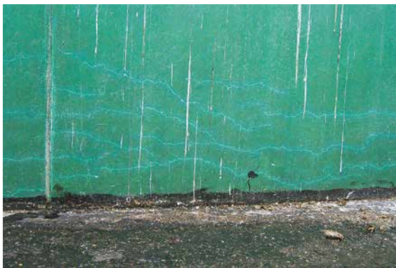
Abb. 12.3 Schutzanstrich mit Rissen
