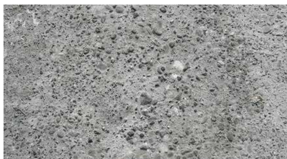
Abb. 10.1 Stark angegriffene Oberfläche
