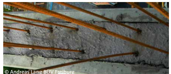
Abb. 13.16 Deutliche Abrisse zwischen Wand und Kernbeton
