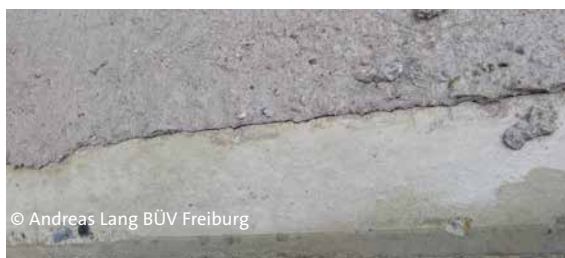
Abb. 13.14 Abrisse zwischen Element und Kernbeton
