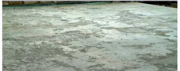
Frostangriff auf frisch betonierte Bodenplatte
